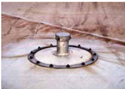
Aérations et évacuations des gaz
