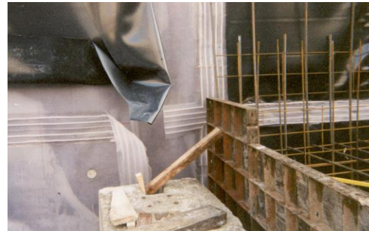
Peligros del impacto mecánico al sistema de impermeabilización
