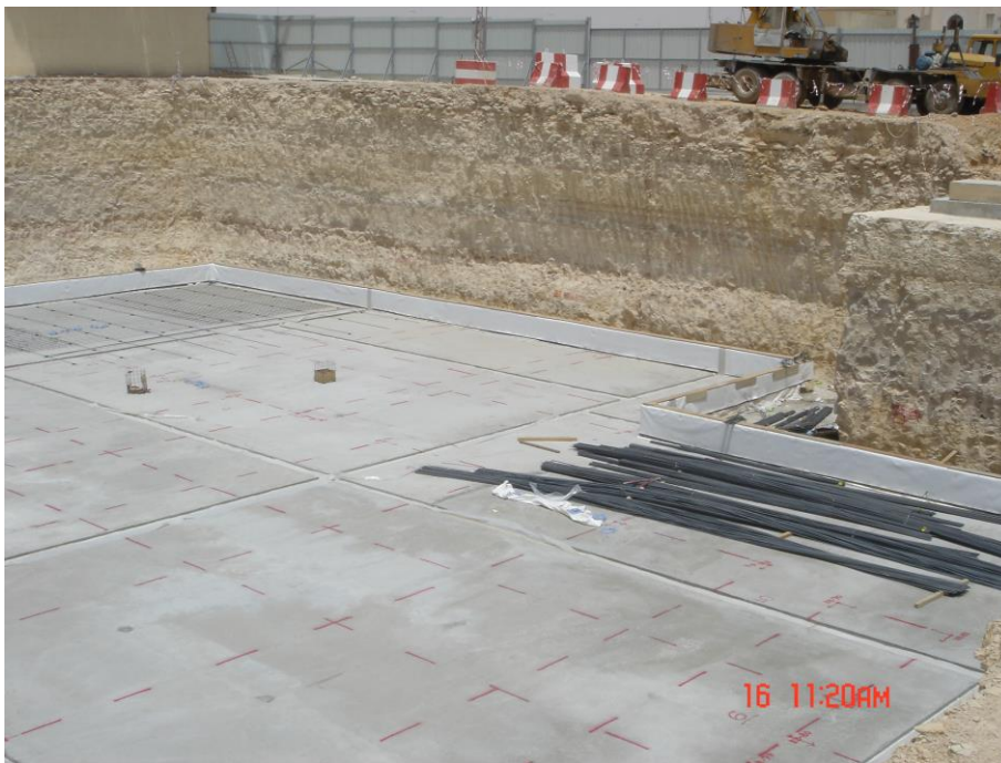
Losa protegida con Water Stops expuestos
